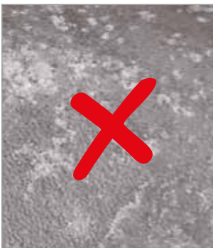
einfache Ausführung: Korrosion
